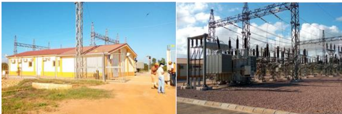
Figura 1. Subestação eléctrica de Massinga
